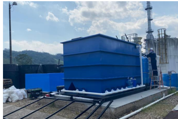
Suministro y puesta en funcionamiento de PTAP en CPF Cup.
