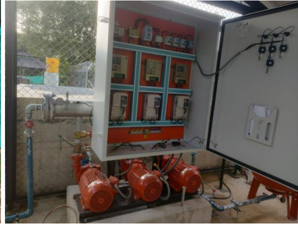
Sistema Eléctrico PTAP CPF Cup
